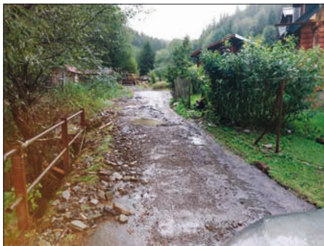
Poškozená cesta v Dinotici
