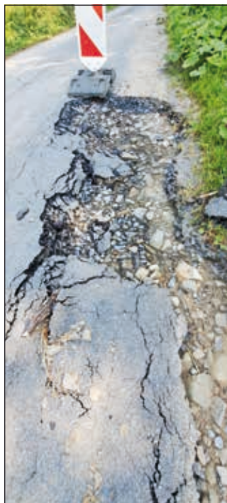
Poškozená cesta v Lušové
